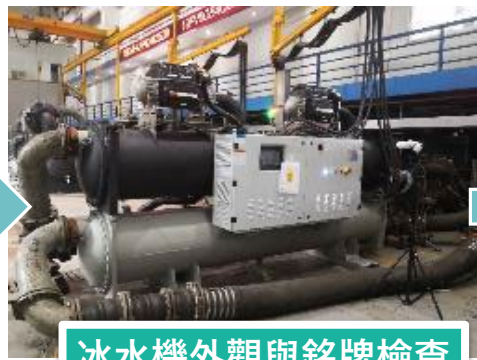
冰水機外觀與銘牌檢查
