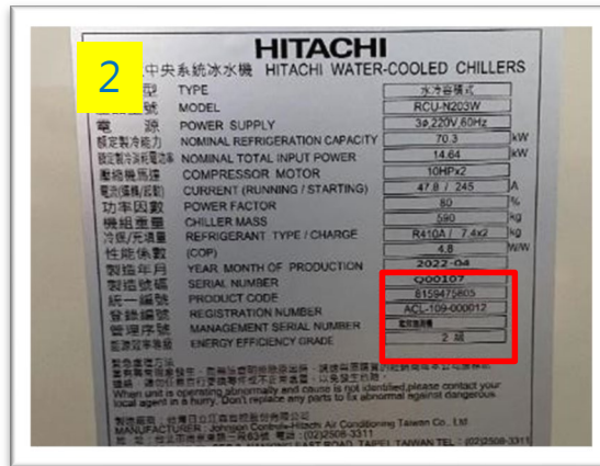
機組銘牌確認
