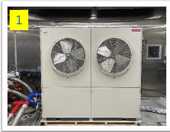
機組外觀確認
